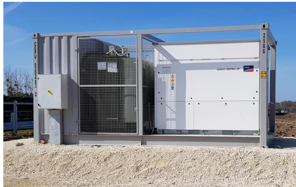
Photo 60 Exemple de poste de transformation (Source : Photosol)
