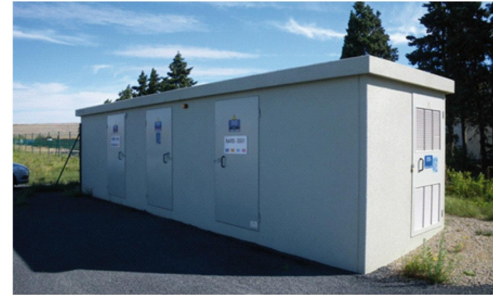
Figure 48 : Exemple de poste de livraison (Source : Photosol)
