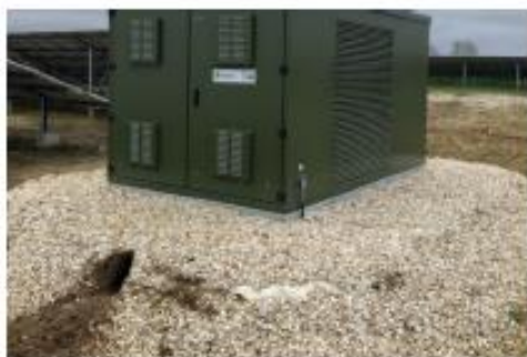
Figure 11 : Terrier sous un poste de transformation – Centrale solaire de Blueberry-Châteauroux (36)
