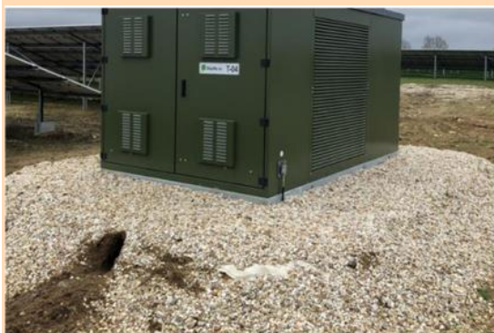
Figure 1 Terrier sous un poste de transformation - Centrale solaire de Blueberry à Châteauroux (36)
