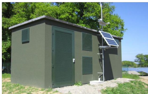
Photo 5 : Exemple de poste de livraison (Total Quadran)
