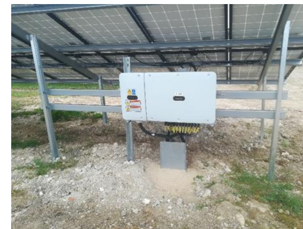
Photo 4 : Vue sur un onduleur et câble enfoui dans le sol (Total Quadran)
