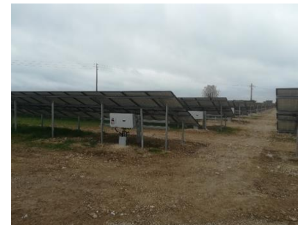
Photo 3 : Vue sur l'arrière des tables où ont été enfouis les câbles (Total Quadran)
