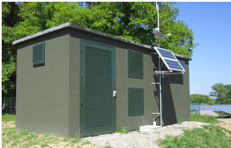
Exemple de poste de livraison
