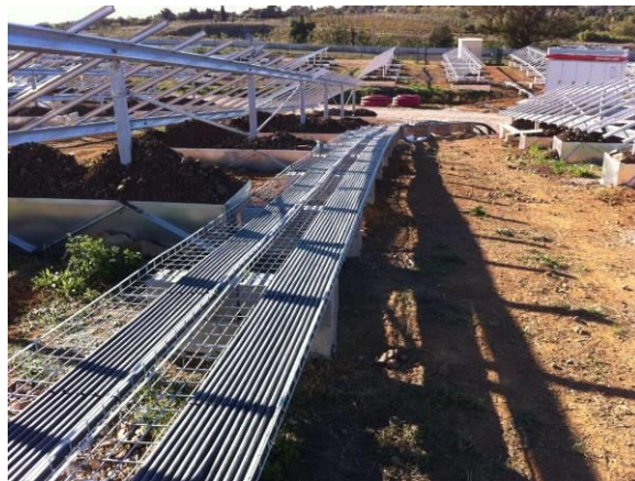
Vue sur des câbles et leurs supports – Source Total Quadran
