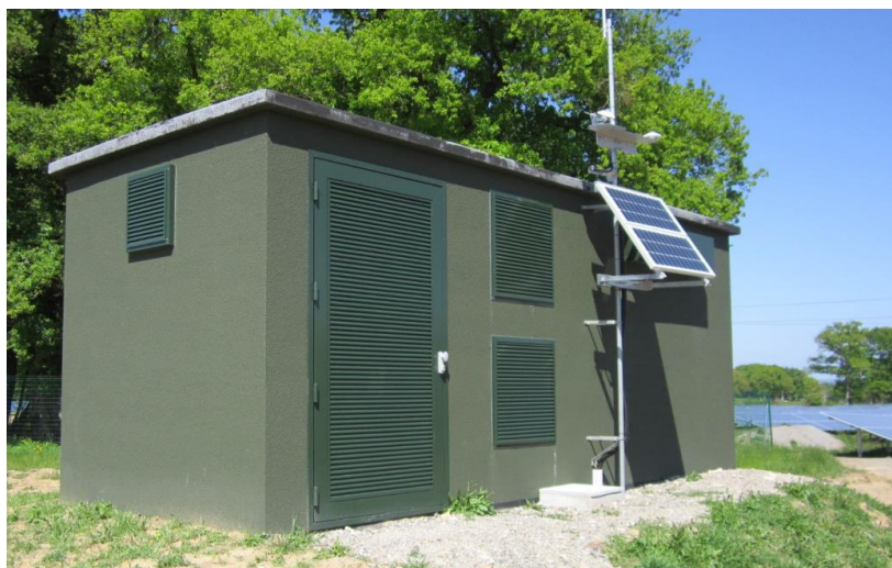
Exemple de poste de livraison
