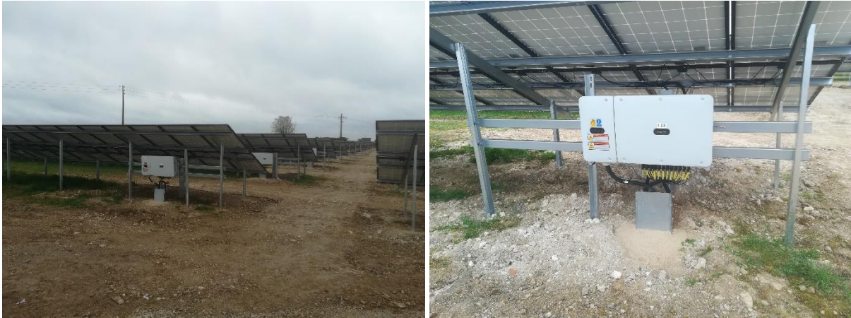
Vues sur un onduleurs et câble enfoui dans le sol – Source Total Quadran
