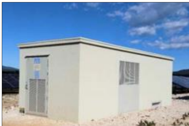
Exemple de poste de transformation
