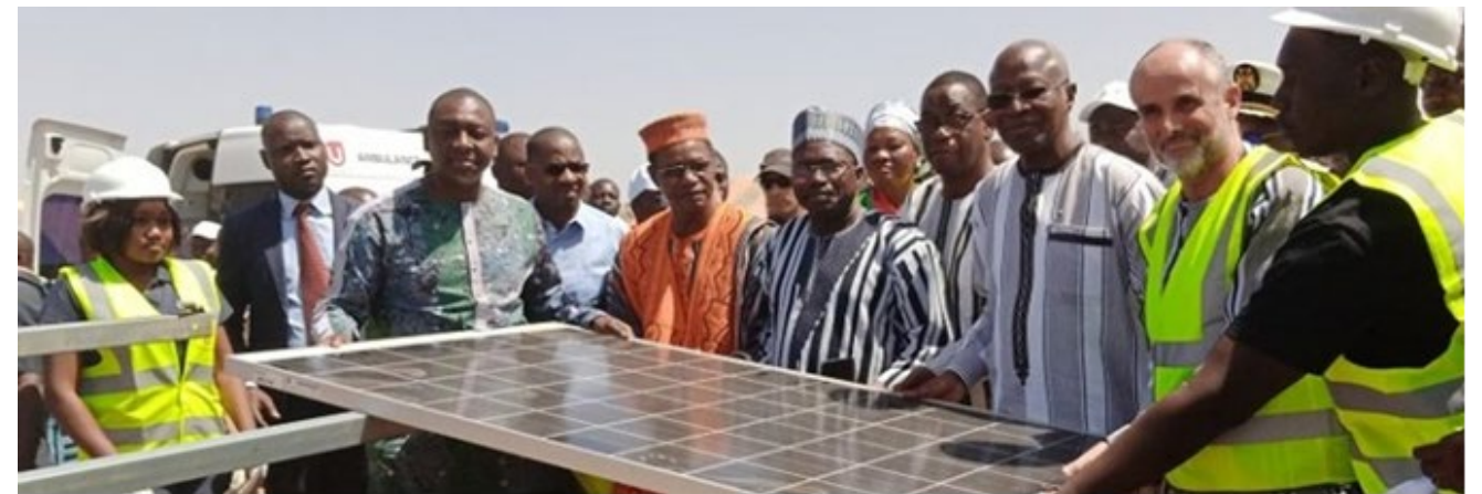
Figure 10 : Pose du 1er panneau de la centrale photovoltaïque de Pâ – Burkina Faso – février 2020 (source : URBASOLAR, 2022)
