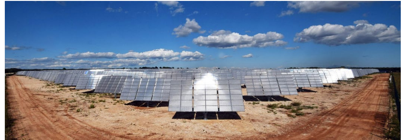
Figure 7 : Exemple d'installation du groupe URBASOLAR (source : URBASOLAR, 2022)
