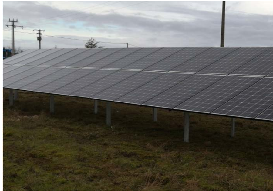
Photo 31. Exemple de structure fixe
