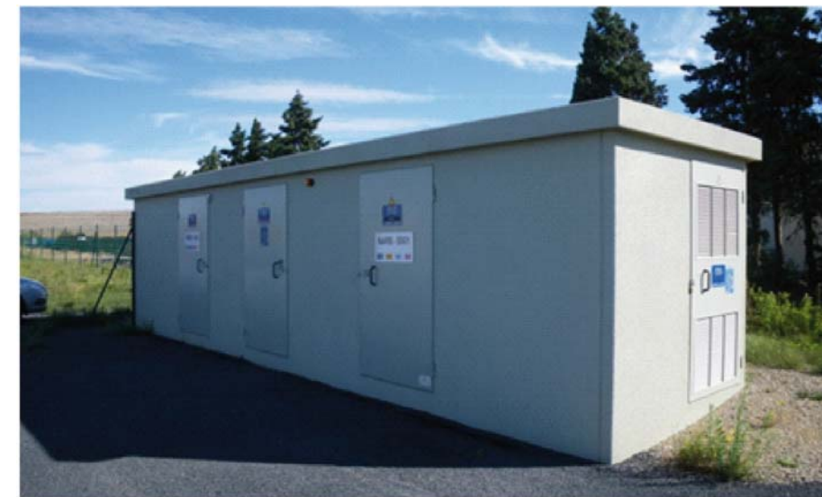
Figure 49. Exemple de poste de livraison
