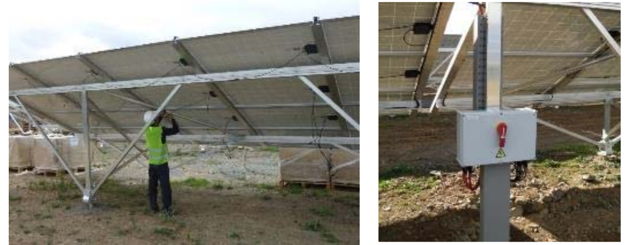
Photo 42. À gauche : Câblage des panneaux – A droite : Boitier de raccordement
