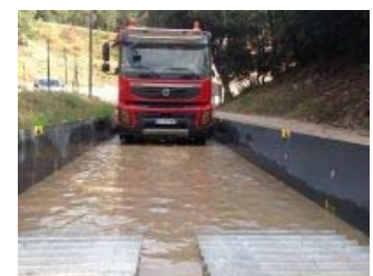
Plateforme de nettoyage des roues
