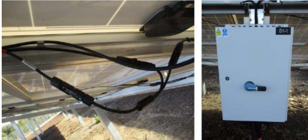
Photo 35. Exemple de câble électrique et de boîte de raccordement
