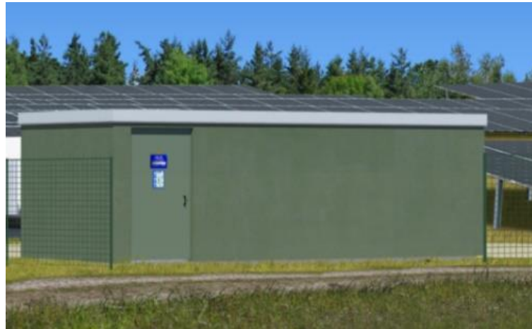
Figure 17 : exemple d'un poste de livraison (Source : EDF Renouvelables)
