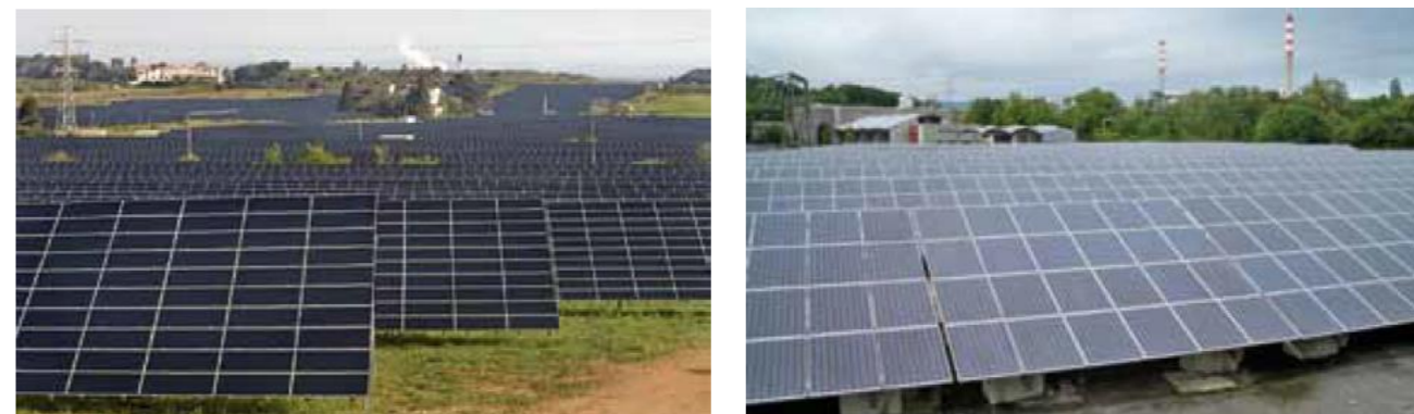
Photo 1 : installations fixes au sol
