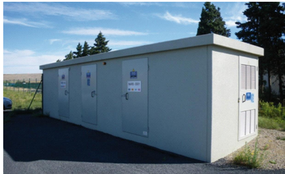
Photo 2 : Exemple d'un poste de livraison
