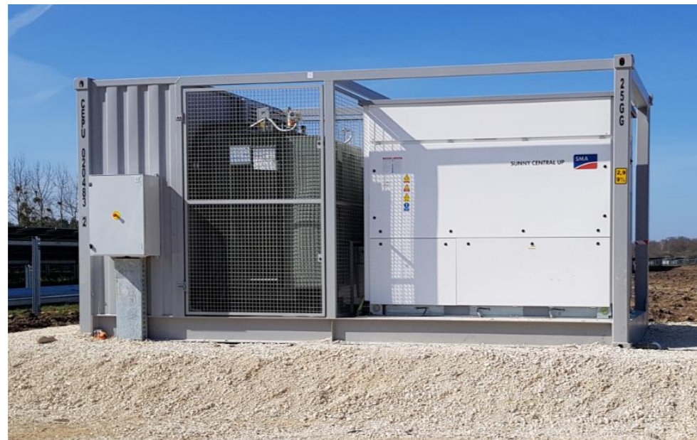
Photo 4 Exemple de poste de transformation (Source : Photosol)
