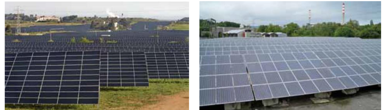
Photo 1 : Installations fixes au sol.
