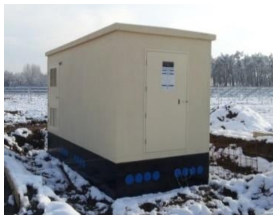
Photo 67 : Exemple de poste de livraison
