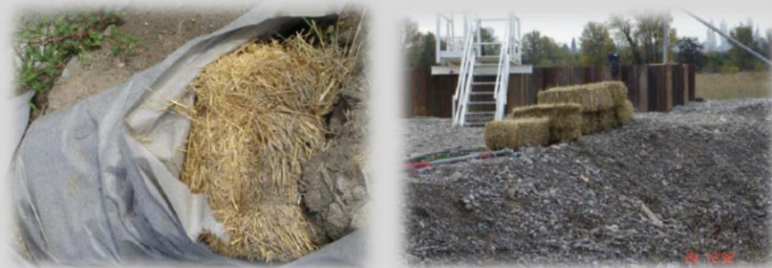
Figure 62 : Filtres à pailles (Source photo : CETE)
