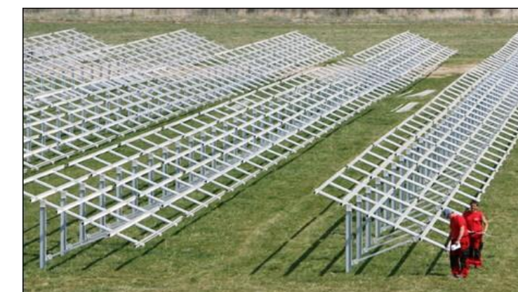
Photo 57 : Exemple de châssis fixes orientés sud
