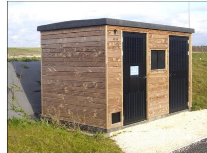
Illustration 6 : Exemple de poste de livraison
