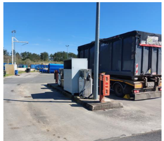
Poste de desserte de carburant
