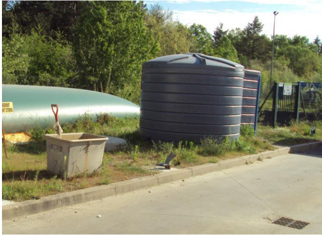
Cuves aériennes ADblue
