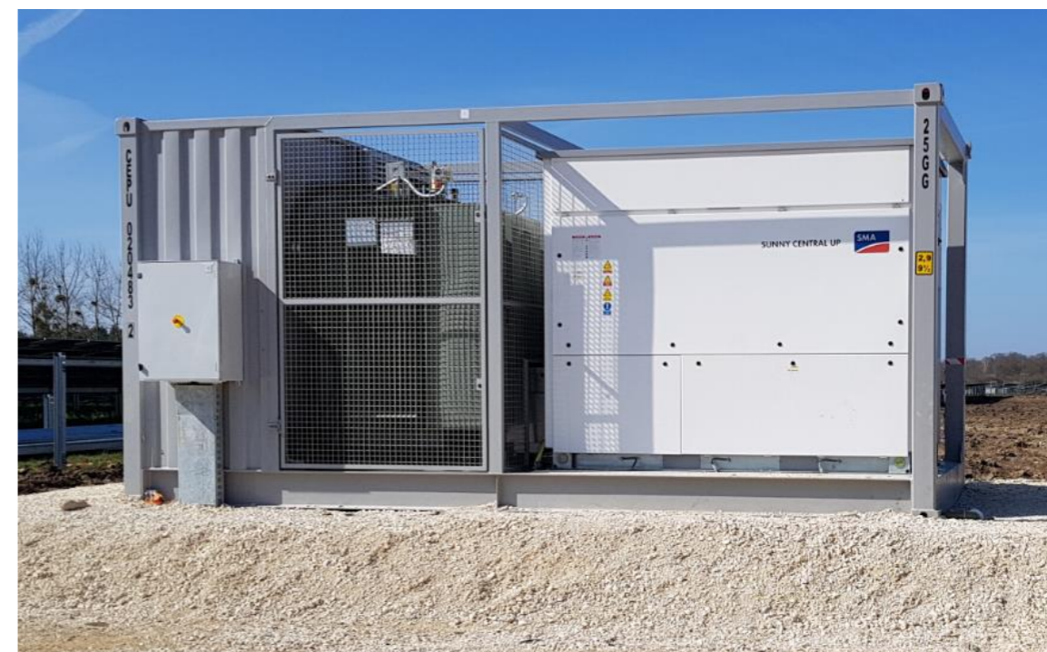
Photo 102 : Exemple de poste de transformation
