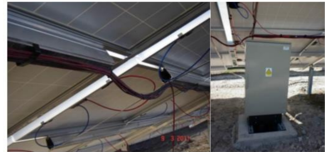
Photo 101 : Illustration du raccordement et d'une boîte de jonction
