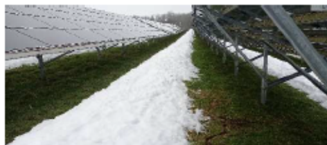
Illustration 3 : Photographie sur le site de Marmanhac montrant la protection des panneaux face aux chutes de neige.
