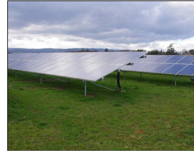
Reprise végétale sous les panneaux photovoltaïques
