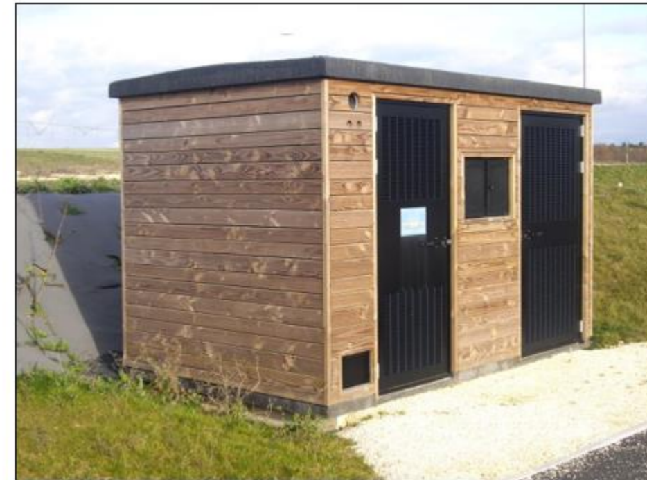
Illustration 20 : Exemple de poste de livraison
