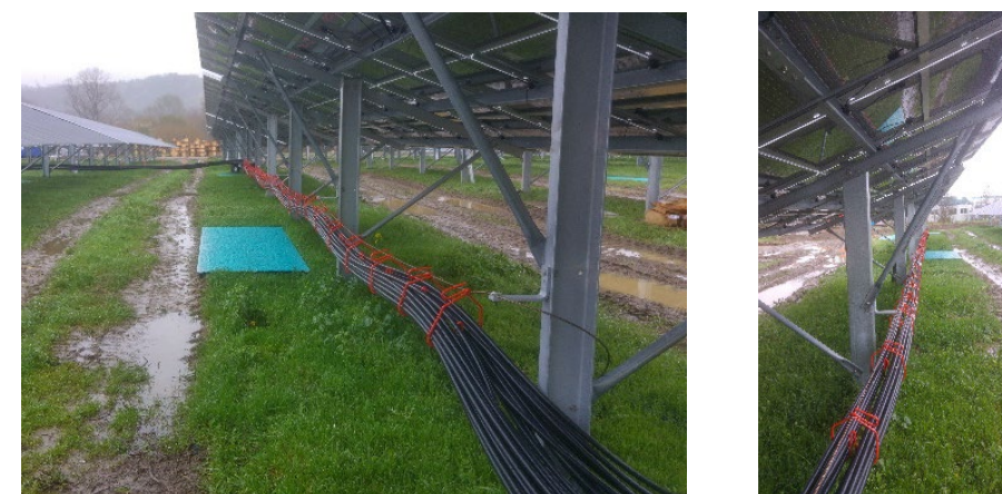
Figure 85 : Exemple de câbles aériens sous les modules (source : URBA 411, 2023)
