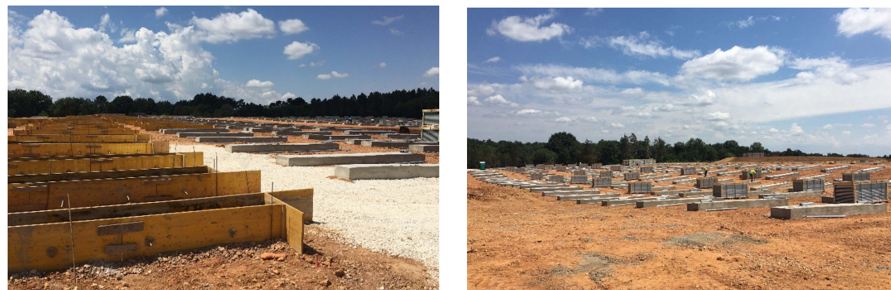
Figure 87 : Exemples d'utilisation de longrines béton sur les chantiers URBA 411 de La Chapelle Gonaguet (24) (source : URBA 411, 2023)
