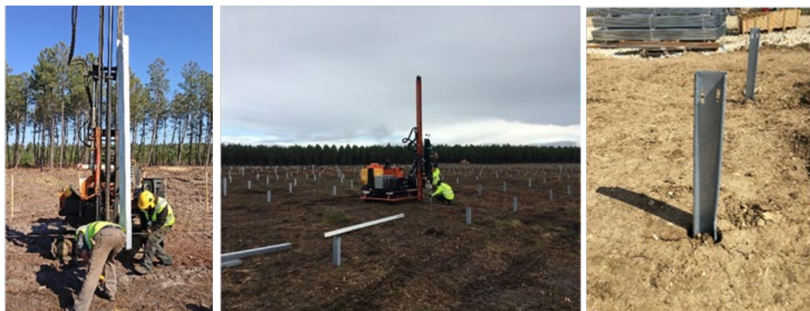
Figure 86 : Exemples de mise en place des pieux battus sur les chantiers (source : URBA 411, 2023)
