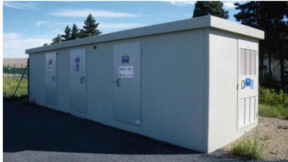
Photo 6 : Exemple de poste de livraison
