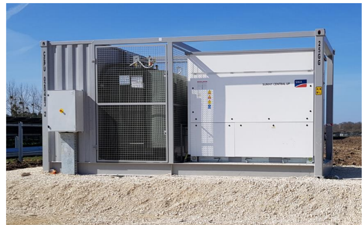
Photo 5 : Exemple de poste de transformation
