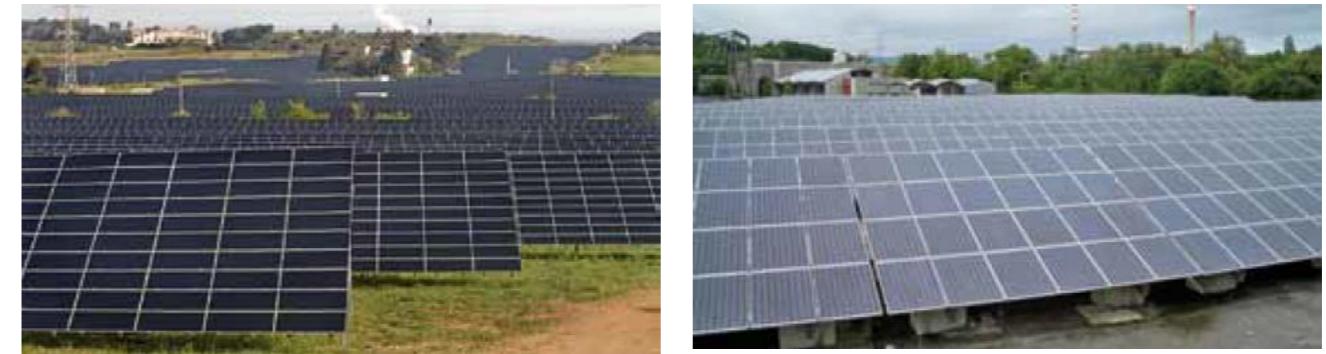
Photo 1 : installations fixes au sol
