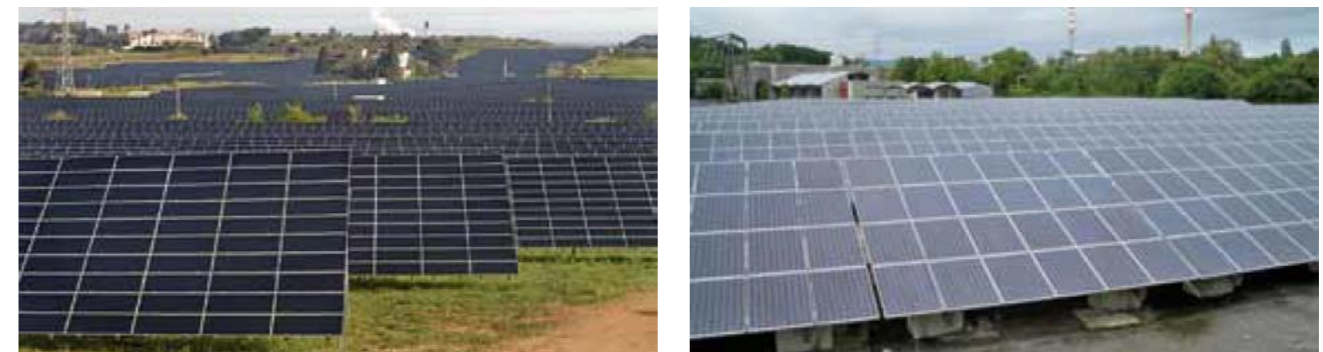
Photo 2 : installations fixes au sol
