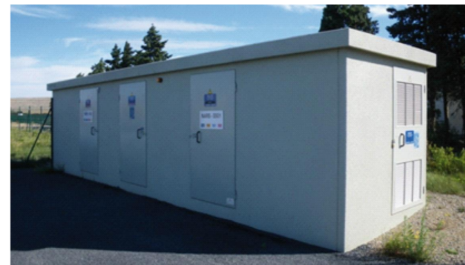
Photo 5 : Exemple d'un poste de livraison
