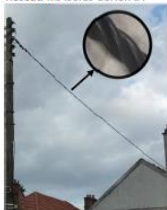
Réseau fils isolés aérien BT
