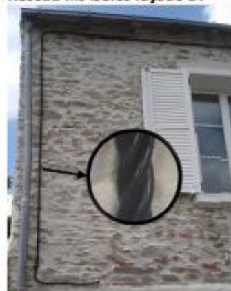
Réseau fils isolés façade BT
