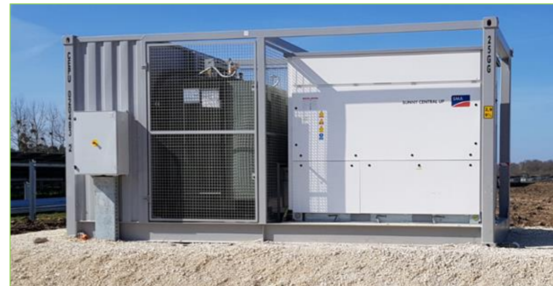
Photographie 3 - Illustration d'un poste de transformation (source : PHOTOSOL)
