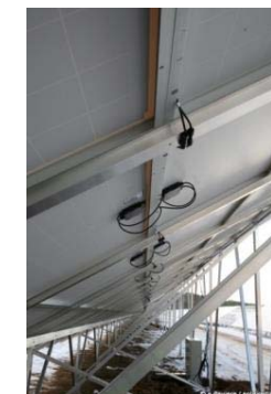
Photo 8 – Câblage sous les modules
