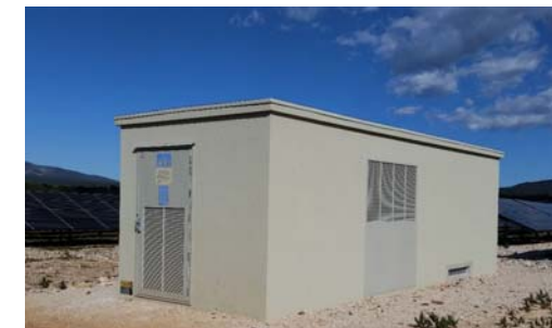
Photo 6 : Exemple de poste de transformation
