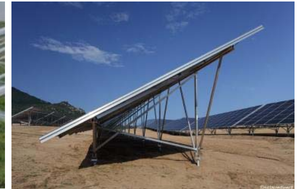
Photo 2 : Structures de support avec modules
