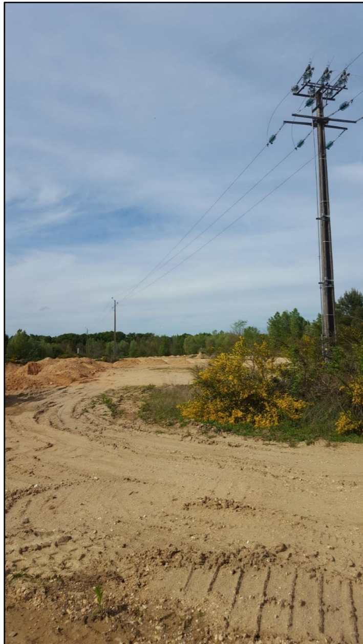
Illustration 22 : Photo de la ligne électrique traversant le site (Source : EREA Ingénierie – mai 2017)
